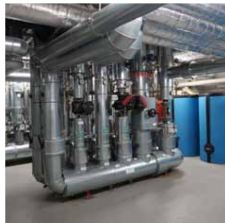
Der Aquiferspeicher am „Bonner Bogen“ übernimmt bis zu 80 Prozent der Wärme- und Kälteversorgung von drei Gebäuden mit einer Gesamtfläche von 60.000 Quadratmetern. (Foto: Paul Fleuchaus)
